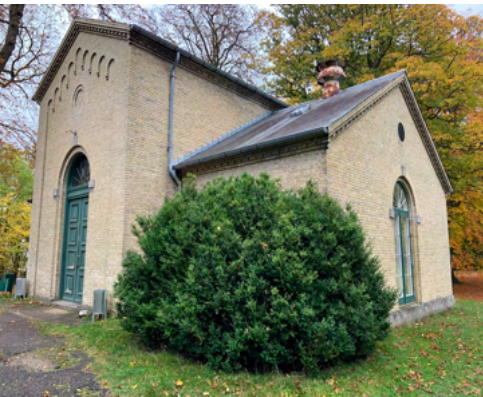
Fig.54. Der må ikke etableres tagvinduer på kapellet. Til gengæld må den rustne udluftningshætte gerne fjernes.
