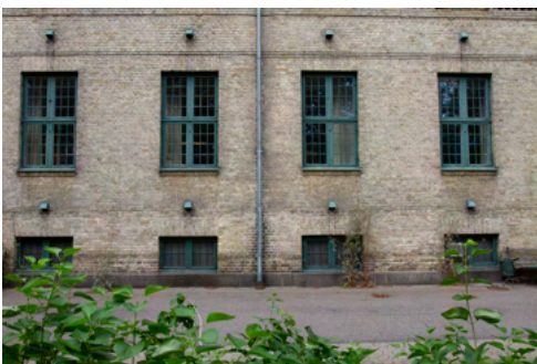
Fig.36. Tagrender og nedløbsrør skal udføres i zink uden synlig overfladebehandling. For at tilpasse tagrender og nedløbsrør til de bevaringsværdige bygninger bør de udføres med samme detaljering og befæstigelse som oprindeligt med loddede eller faldede samlinger og knæk (bajonetknæk). Rendejern bør udføres med vulst.
