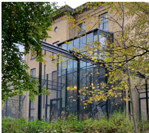
Fig.40. Glastilbygningen og indhegningen på Sønderhus' sydfacade må rives ned og erstattes med vinduer som oprindeligt eller med franske altaner.
